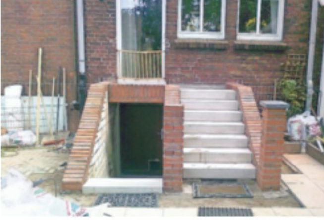
Kellertreppenabgang und Terrassenzugang in einem. Jeder noch so individuelle Wunsch ist für Dietmar Liebig eine willkommene Herausforderung. Foto: privat
