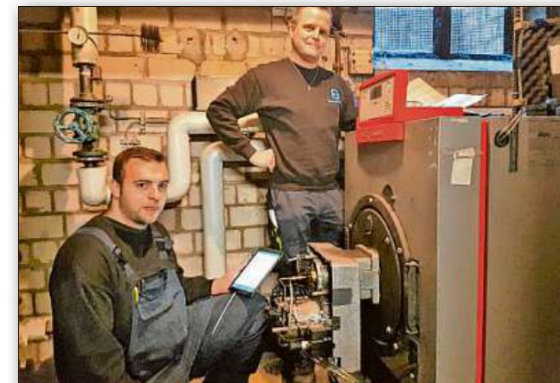
Die Anlagenmechaniker für Sanitär-, Heizungs- und Klimatechnik, Jochen Frings (links) und David Giesen, checken einen Ölbrenner. Wegen Corona wissen sie nur bedingt, wie sich der Start ihres Unternehmens entwickeln wird.
